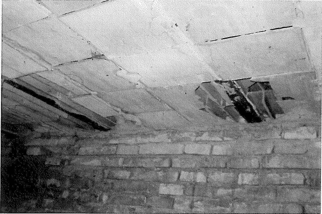
5 – SFONDELLAMENTO DELLE CARTELLE DELLE PIGNATTE IN LATERIZIO
