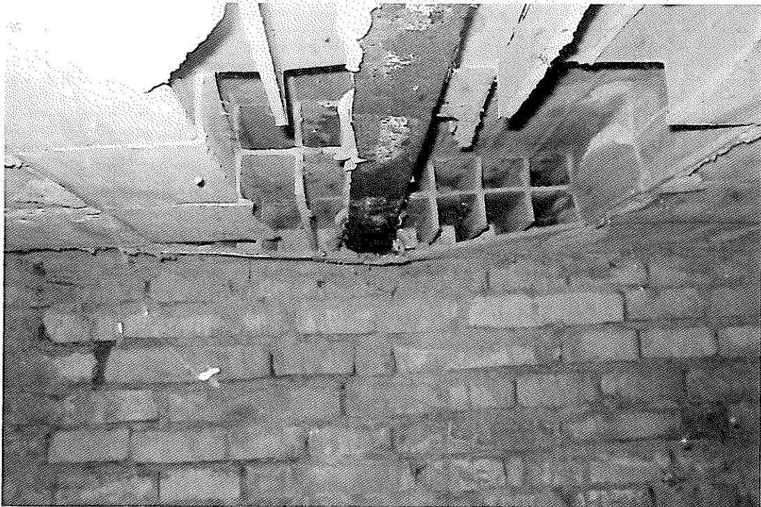
6 – PIANO INTERRATO: CEDIMENTO DEL SOLAIO
