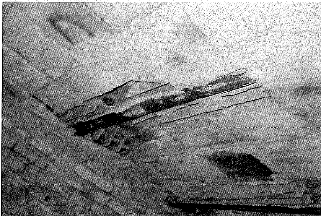
3 – PIANO INTERRATO: PROBLEMATICHE DEL SOLAIO IN FERRO E PIGNATTE
